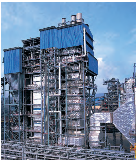
Caldeira CFBC com Separador Compacto de 150TPH, em Jindal Steel and Power Ltd., Raigarh, (Chattisgarh), Índia
