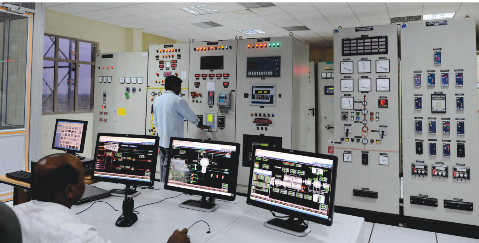
Sala de Controle da Caldeira
